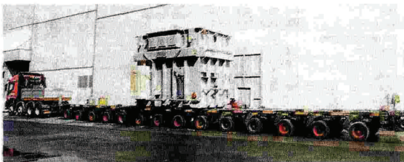
Ecco uno dei trasformatori posizionato sul mezzo della FT International
