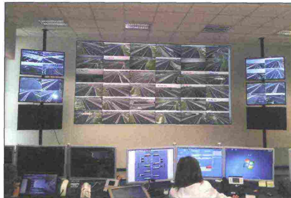
5. La postazione operatore e il videowall nella sala radio della A35 Bre.Be.Mi.
