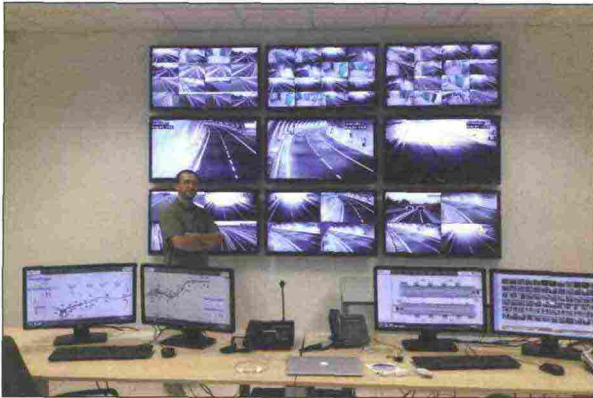
3. Monitor e piattaforma di controllo del traffico della Distelco presso la sala radio di Pedemontana
