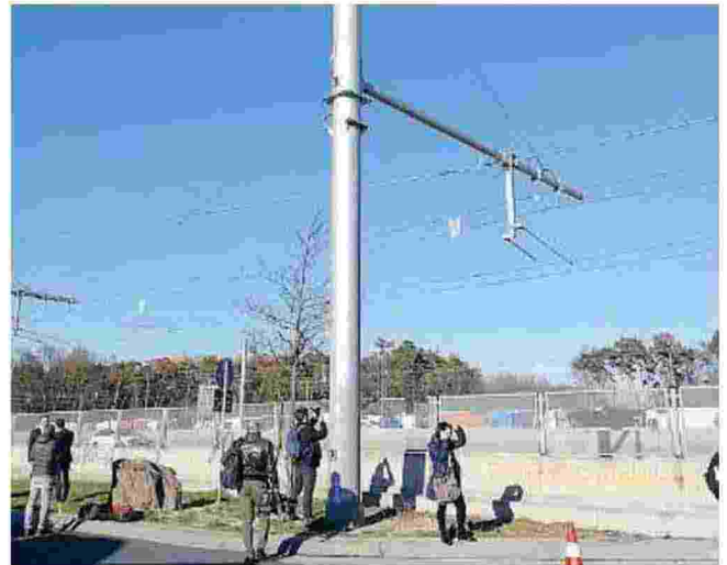
Tecnologia. I pali e le linee di contatto per la distribuzione dell'energia
